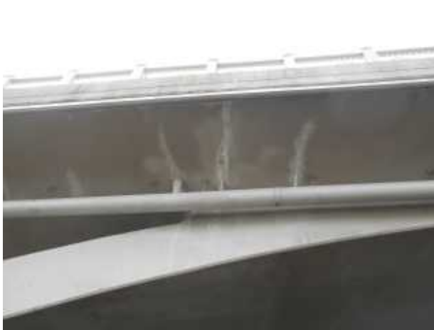
(S2) 균열 및 백태 (CW=0.3mm, L=1.0m)
