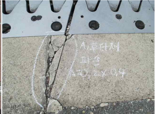
A1 후타재 파손
