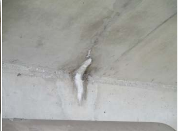
(S2) 아치리브 균열 및 백태 (CW=0.2mm, L=1.0mm)
