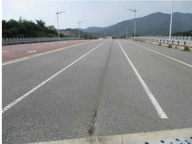
S1 아스콘 균열
