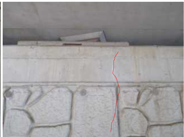
A2 교대 균열(CW=0.2mm, L=1.2m)
