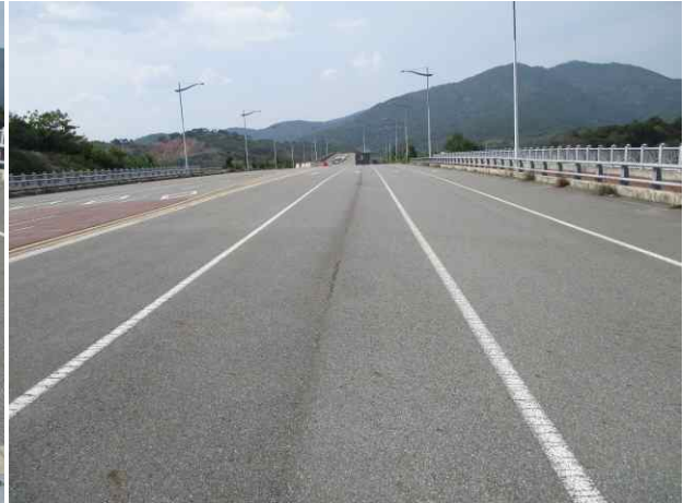
S2 아스콘 균열
