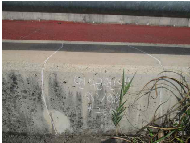
S1 연석 균열
