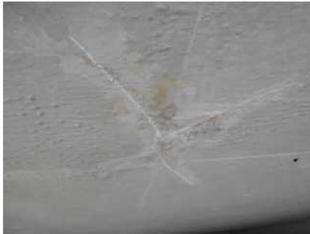
(S2) 아치리브 균열 및 백태 (CW=0.2mm, L=1.0mm)
