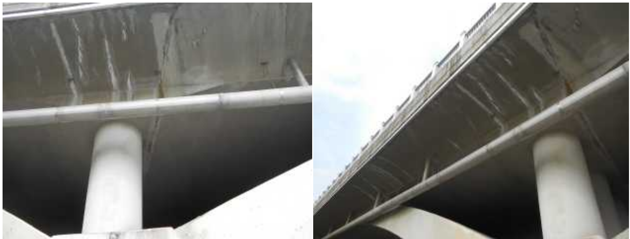
(S2) 균열 및 백태 (CW=0.2mm, L=1.0m)
