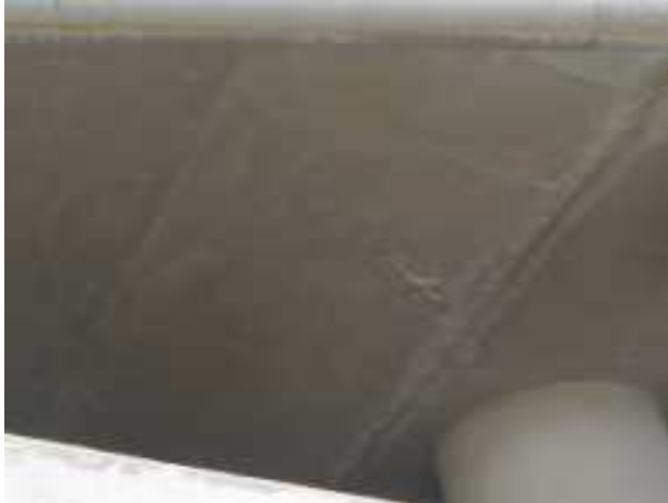
(S2) 아치리브 균열 및 백태 (CW=0.2mm, L=1.0mm)
