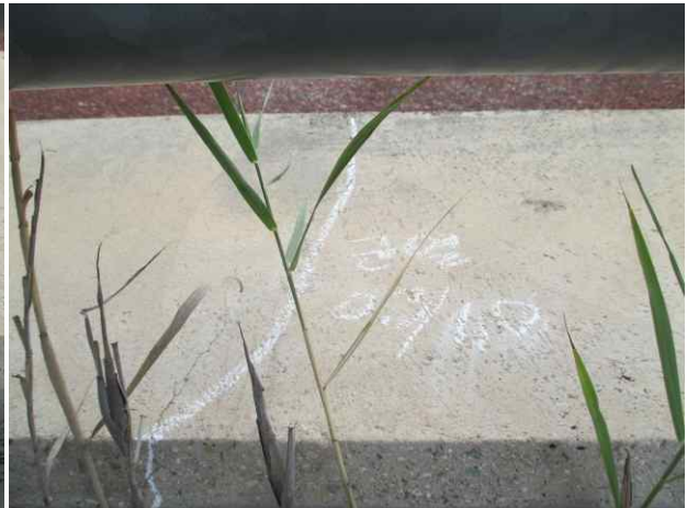
S3 연석 균열
