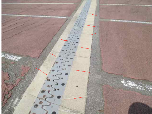
A1 후타재 균열
