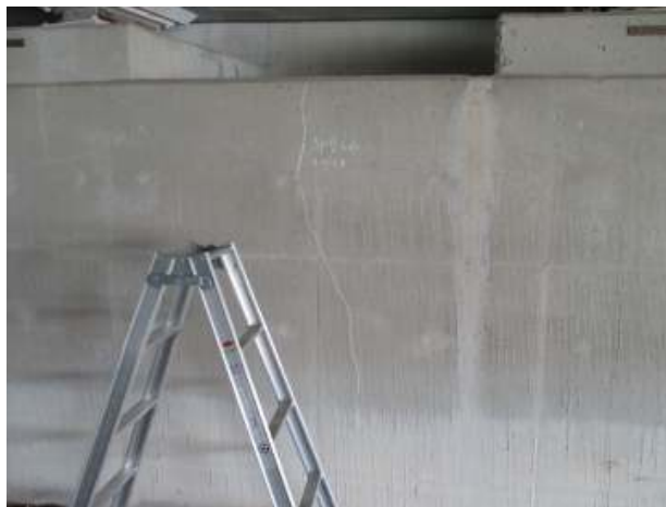
A1 교대 균열(CW=0.2mm, L=1.8m)
