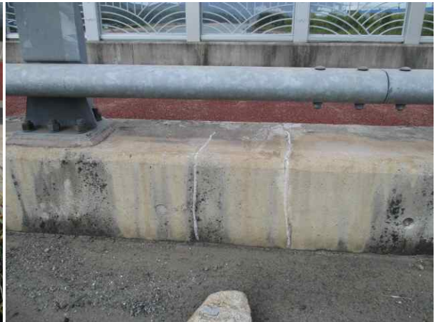
S3 연석 균열
