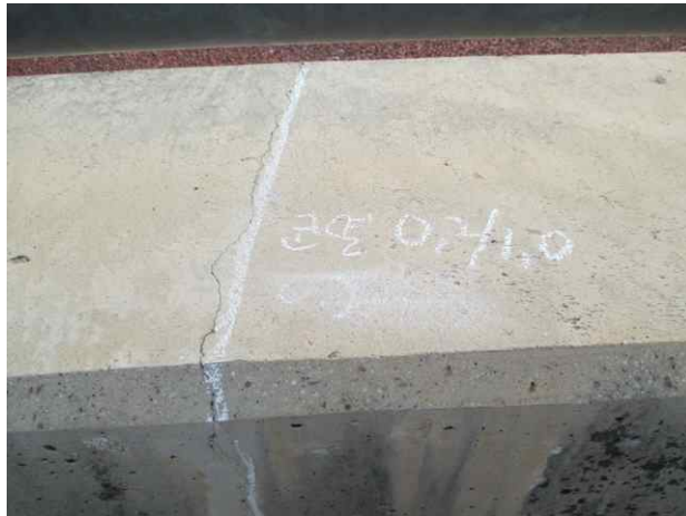
S2 연석 균열
